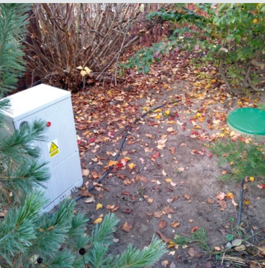
Skrzynka techniczna i pokrywa zbiornika
