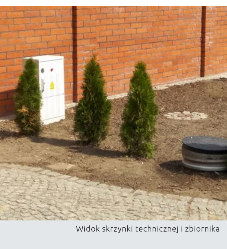
Skrzynka techniczna i pokrywa zbiornika
